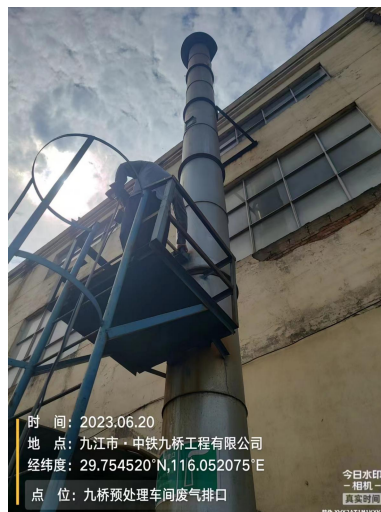
预处理车间废气出口采样
