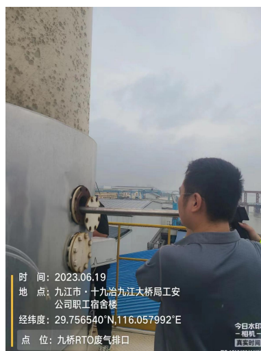
RTO废气出口采样
