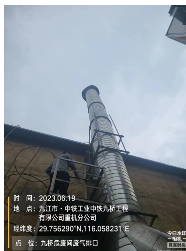
危废间废气出口采样
