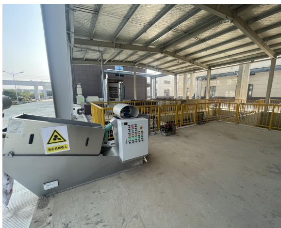
污水处理设施
